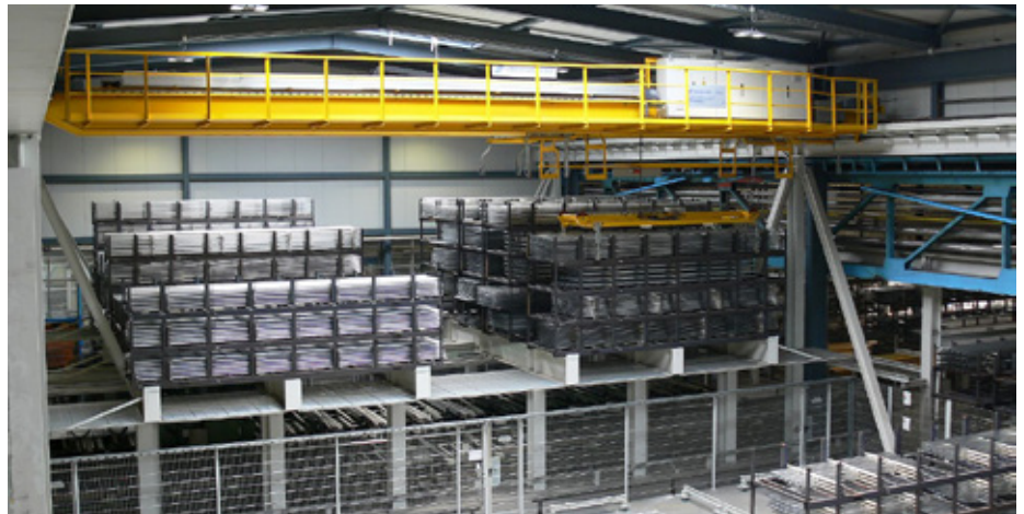
Die neue Automatikkrananlage ergänzt nahtlos diese bereits vorhandene vollautomatische Intralogistik von H+H Herrmann + Hieber. Bild: H+H
